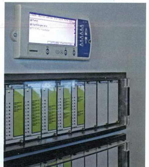
Für thermoaktive Bauteile bietet Siemens speziell getestete Desigo-Regelungsmodule an.
